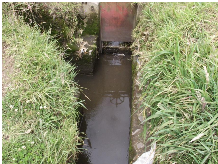
Foto 6-6 Alteración del agua del acequia
